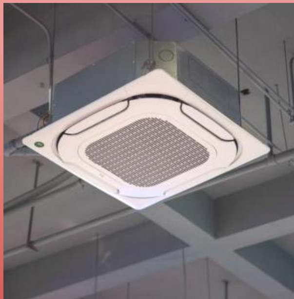
中央空调清洗/消毒
